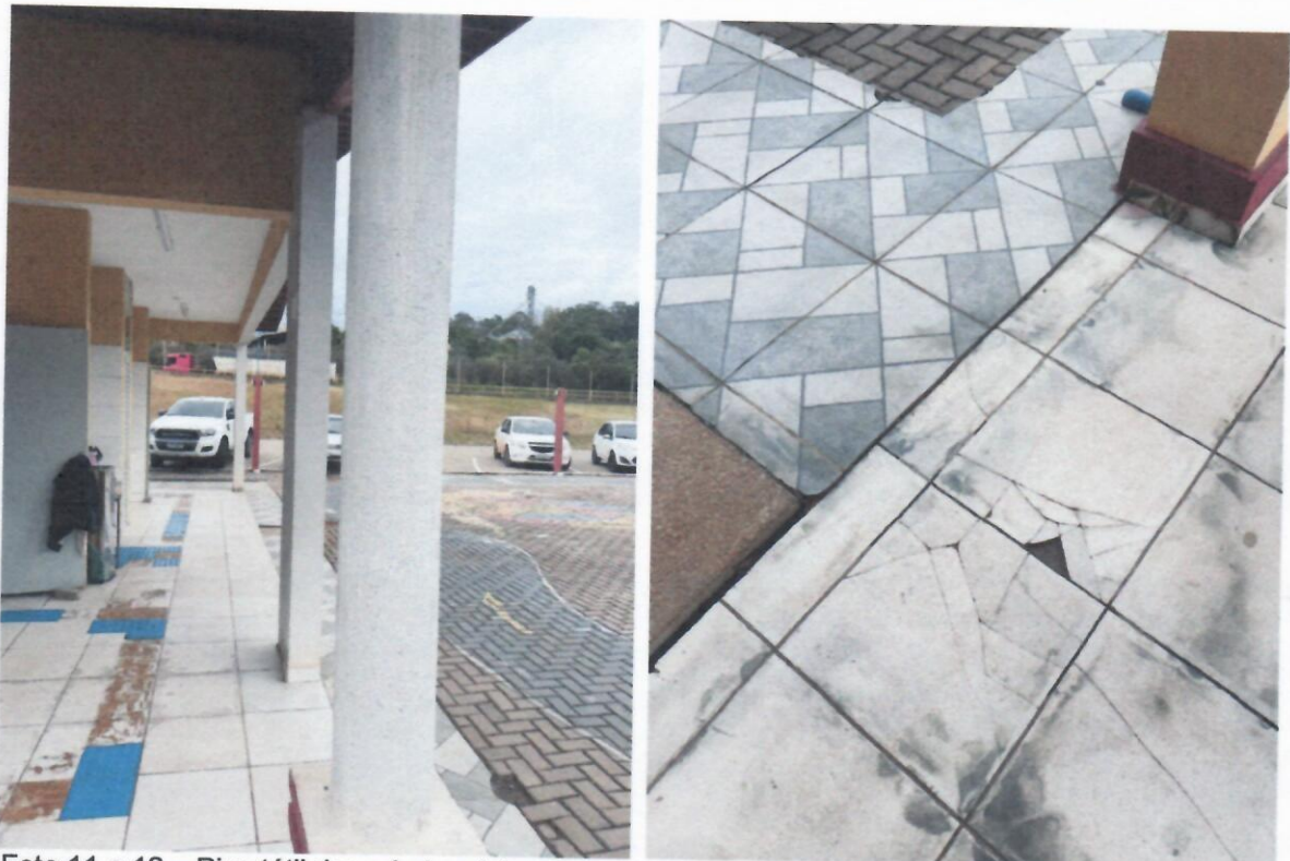
Foto 11 e 12 – Piso tátil descolado; pintura em estado de degradação, com escorrimentos visíveis; piso trincado.
