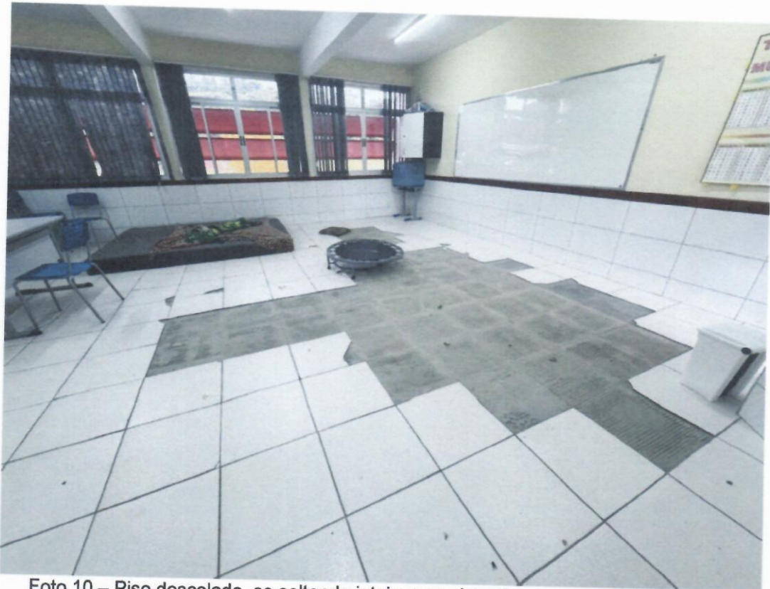
Foto 10 – Piso descolado, se soltando inteiro e quebrando peças por estarem ocas.
