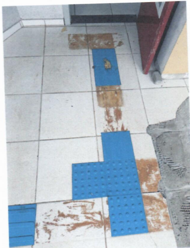
Foto 6 – Piso tátil descolado; rodapé descolado; cerâmica descolada e quebrada.
